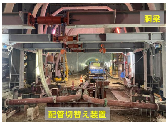
写真-3 スライドセントル内の設備
