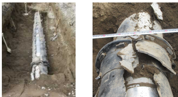
写真-2 ダクタイトル鉄管 破碎状況
