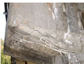
写真-3 A S R によるひび割れ
