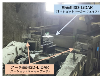
図-9 2種類の3D-LiDARの設置状況
