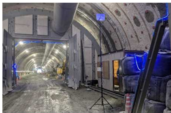
写真-2 屋外長距離通信性アンテナ 配置状況(その2)
