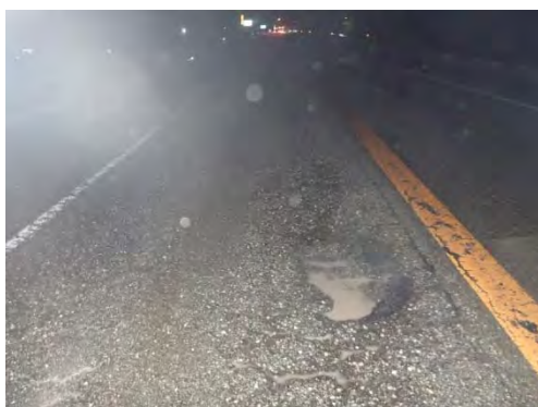
写真－2 路盤まで破損したポットホール
