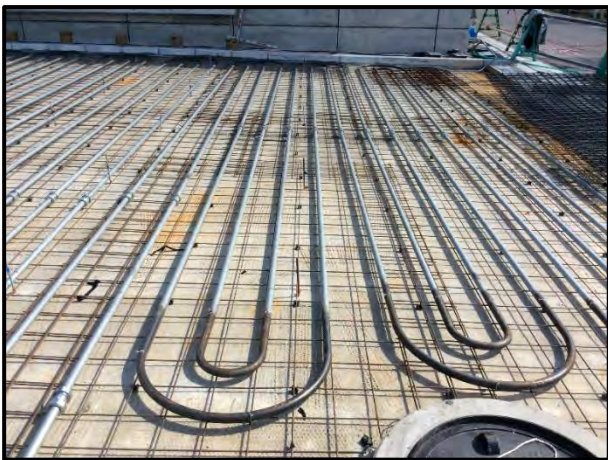
写真-2 リターンベンド配管状況
