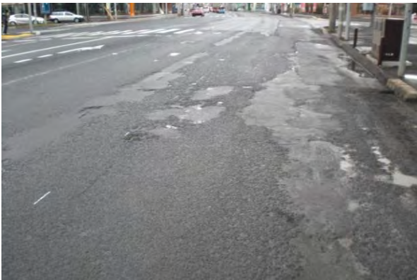
写真-2 排水性舗装の内部破損例
