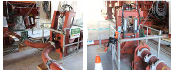
写真-1 配管系統の高速切替え装置
