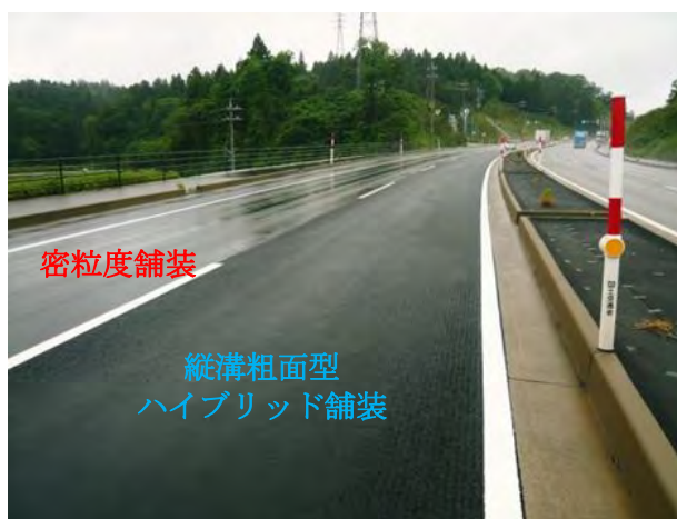
写真-4 縦溝粗面型ハイブリッド舗装浮き水抑制
