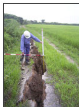
写真－2 被災状況その 2 ※
