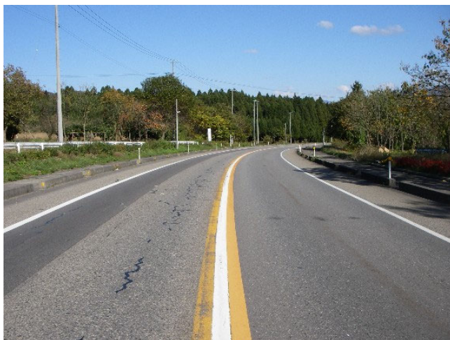
写真-2 1年経過後の路面状況 (右側車線が加熱表面処理工法)
