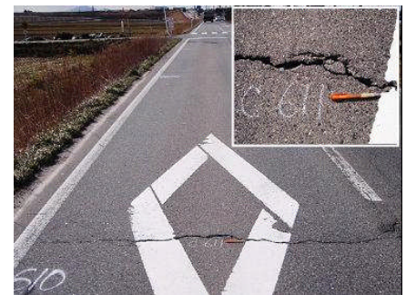
写真－1 セメント安定処理区間に発生したひび割れ
