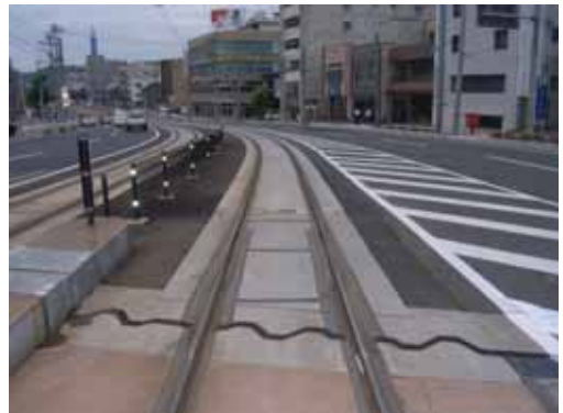
写真-6 供用後の伸縮装置部 (福井)
