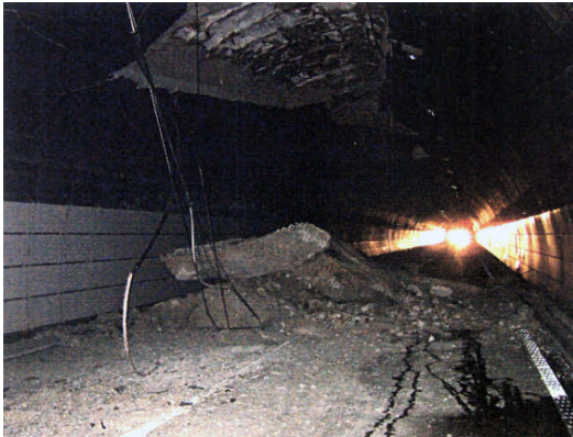
写真-1 コンクリートの剥落
