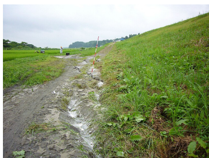
写真－1 被災状況その 1 ※
