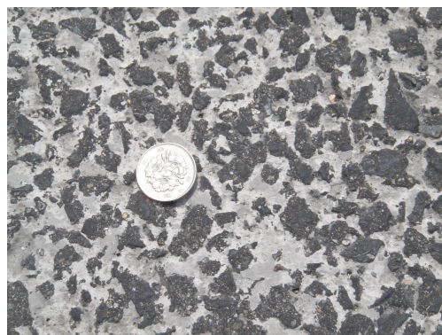
写真-5 施工2年目の表面の状態
